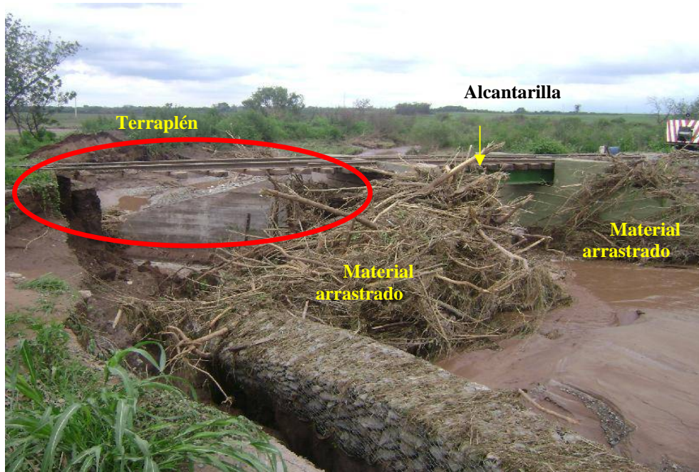
Figura 7: Margen izquierda de la alcantarilla vista desde aguas arriba luego del paso de la creciente.
