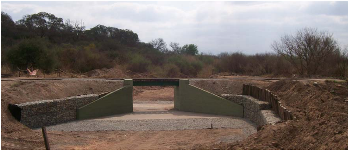
Figura 4: Fotografía de la alcantarilla en estudio tomada al concluir su construcción. Vista desde aguas abajo.
