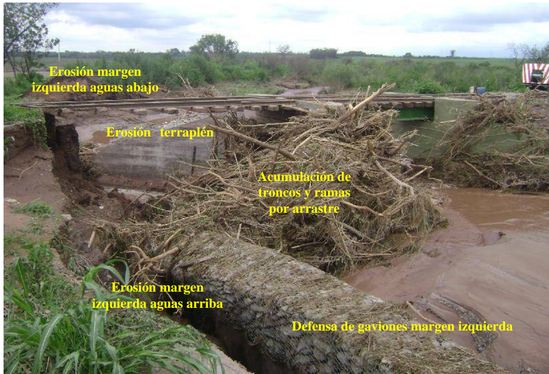
Figura 10: Análisis del colapso del terraplén lateral.
