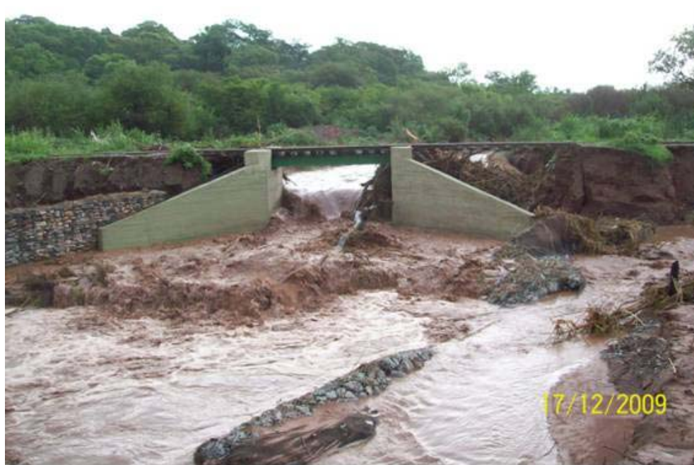
Figura 5: Vista de la alcantarilla desde aguas abajo. Fotografía tomada aproximadamente 12 horas después de la precipitación del 17 de diciembre.
