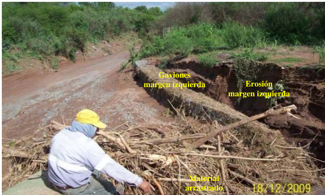
Figura 8: Defensas sobre margen izquierda aguas arriba de la alcantarilla.
