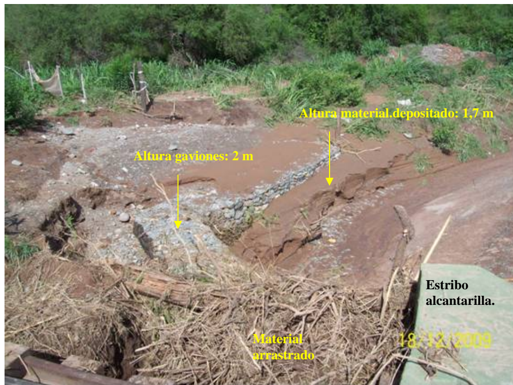
Figura 6: Defensas sobre margen derecha aguas arriba de la alcantarilla luego del evento hidrológico de referencia.
